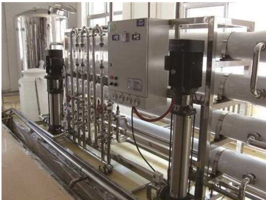
南岔格润药业水处理车间
